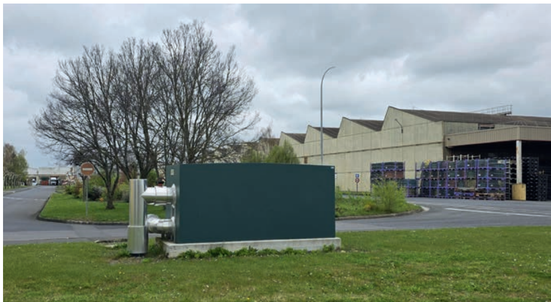
► Des deux puits existants sur le site, l'un est resté dédié à l'usage d'eau pour le process industriel, l'autre est désormais utilisé pour la géothermie en réinjection. Un troisième a été foré pour le captage de la géothermie.
