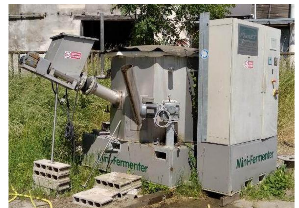
Pilote de méthanisation continue en voie liquide 1 m 3
