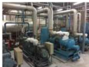
SALLE DES MACHINES
