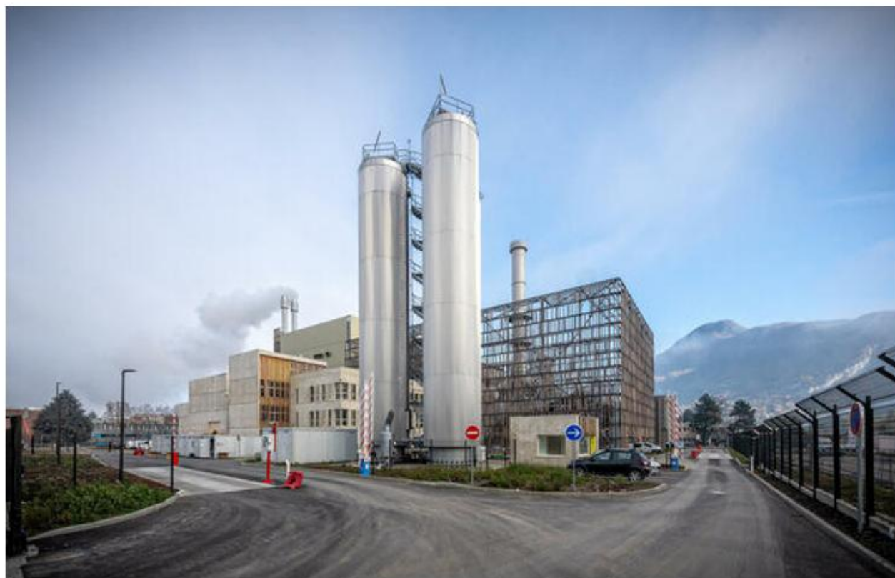
Figure 3. Cuves sous pression de la chaufferie Biomax à Grenoble (source: https://www.compagniedechauffage.fr/ )
