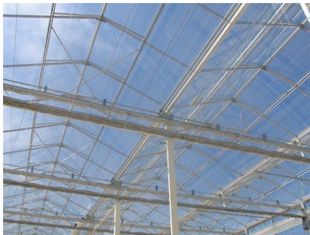
Figure 9 : Présence de deux toiles d'écran au niveau de la poutre treillis (source CTIFL ©)
