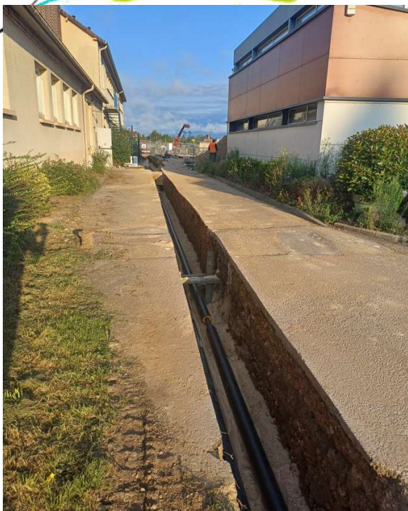
Réseau de chaleur + entrée Sous-station de livraison
