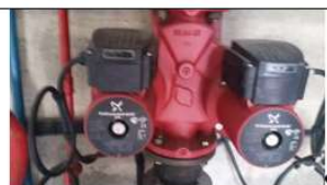
circuits chauffage 1 pompe double Grundfos UPS-D65-60-2-F [année 2012]
