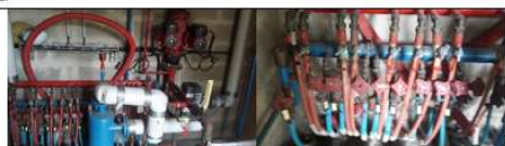
Départs des circuits radiateurs basse-température
