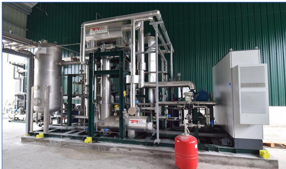
Figure 3 - Le module de séparation du CO 2 de l'offgaz chez Sanamethan, photo Frédéric Douard
