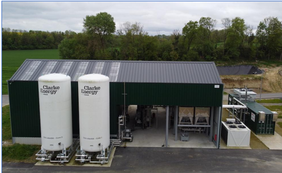
Figure 2 - Gauche : réservoirs de stockage du CO2 | Droite : unité de purification du biogaz
