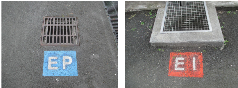
Vanne d'isolement EP polluées
