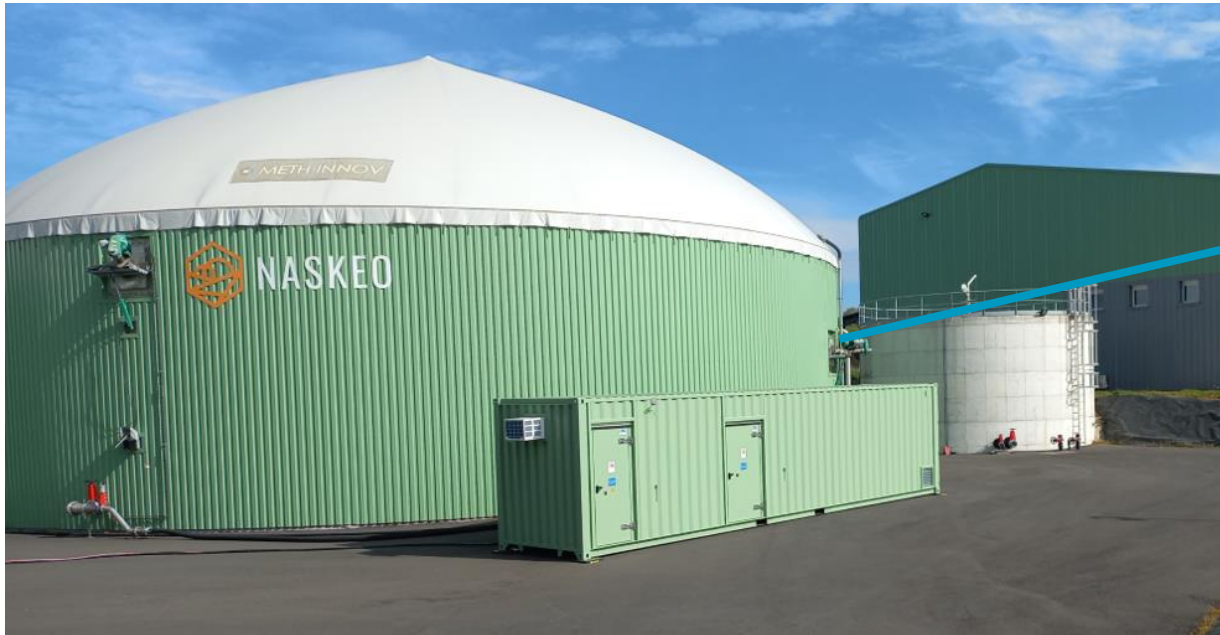
Installation conteneur pilote
