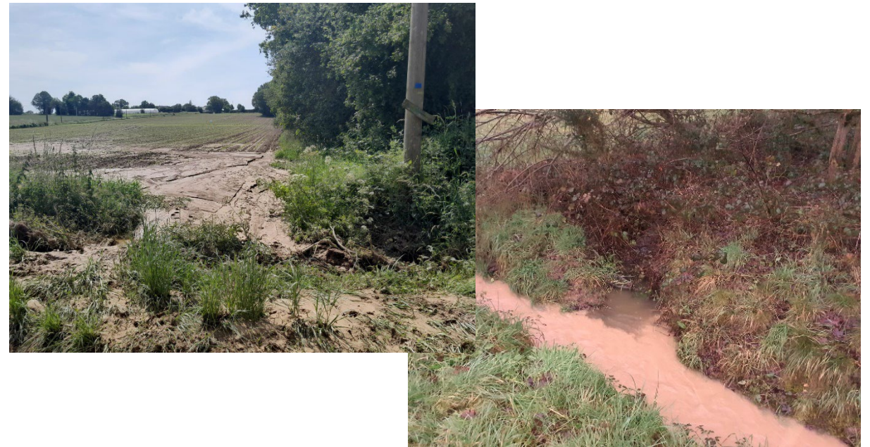
Effet du ruissellement de surface sur un sol sensible à l'érosion (Muel, 35)
