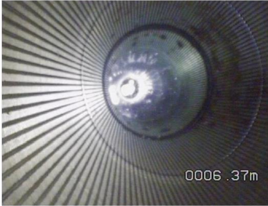
Vue sur la crépine fil enroulé, taches éparses couleurs rouille sur un côté du tube
