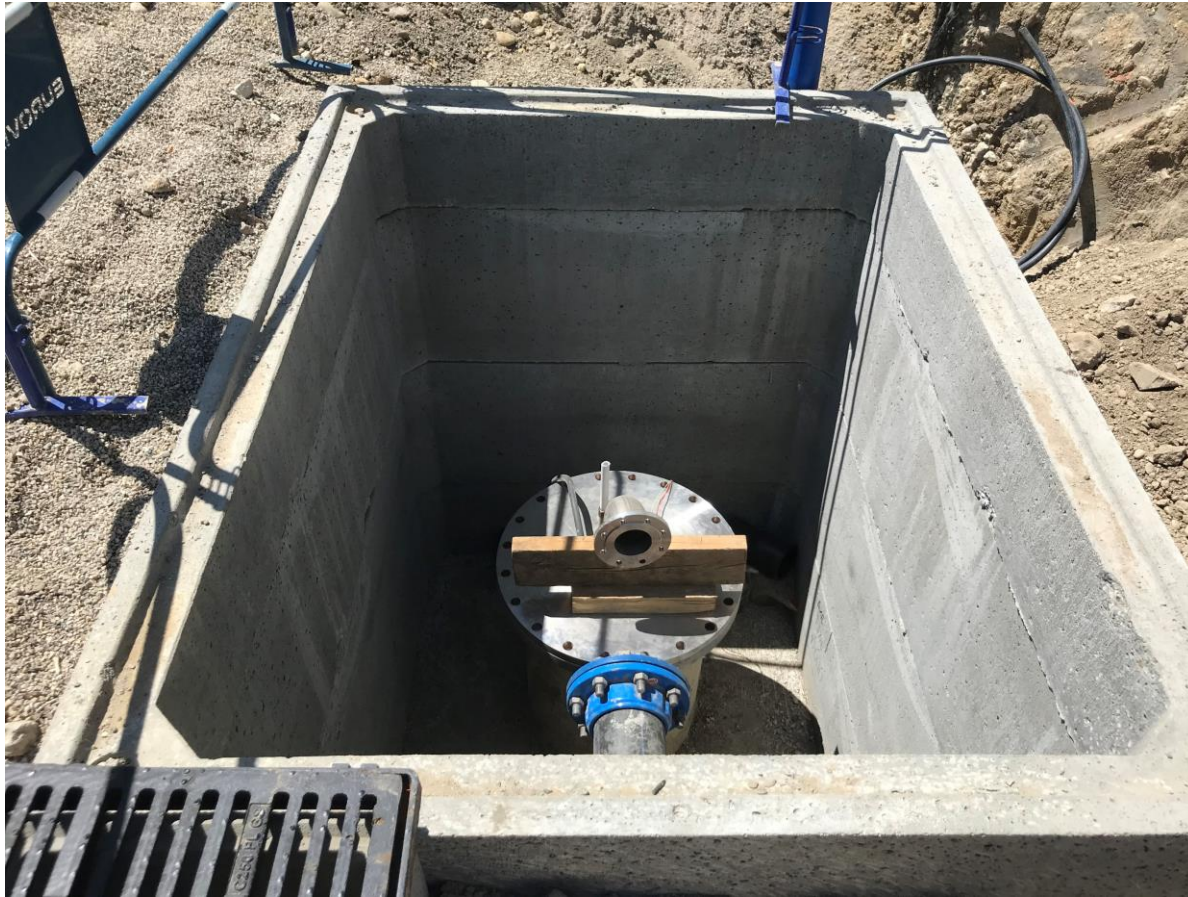
Chambre de forage enterrée avec tête
