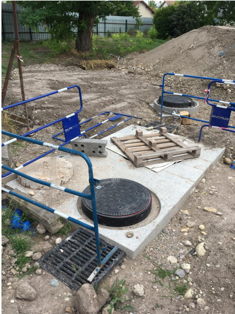
Chambre enterrée de forage
