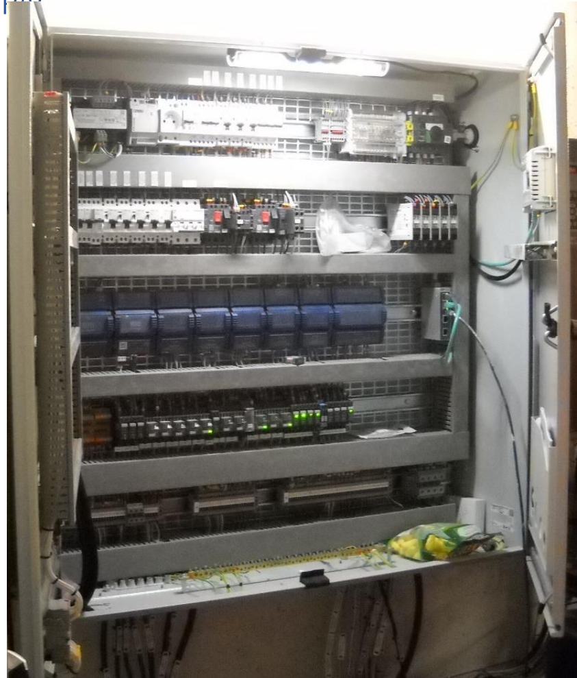
Armoire de commande
