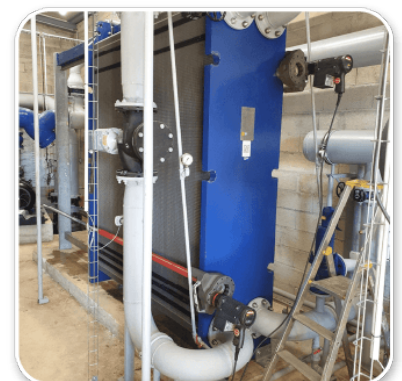
Echangeurs de chaleur
