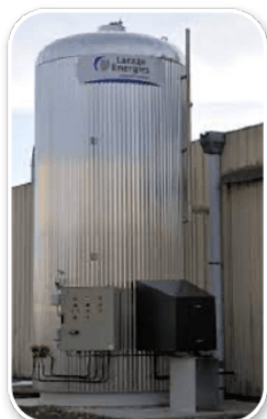
Brûleur gaz intégré au stockage
