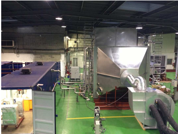
ORC sur fumées basses températures ( 120 °C)
