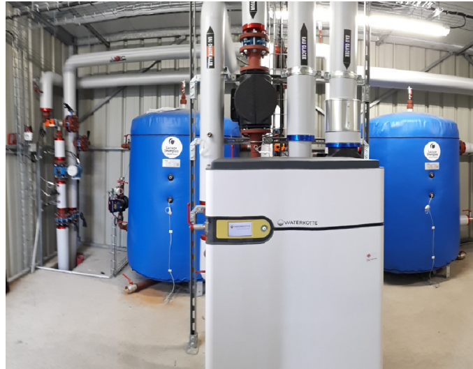
Un local technique abritant la pompe à chaleur
