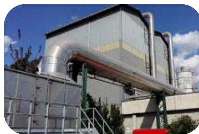
Récupération de chaleur fatale
