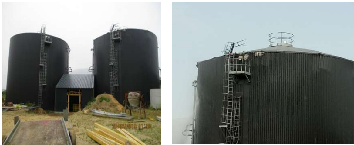
Figure 7 : Vue d'une installation de méthanisation en phase de fin de conception
