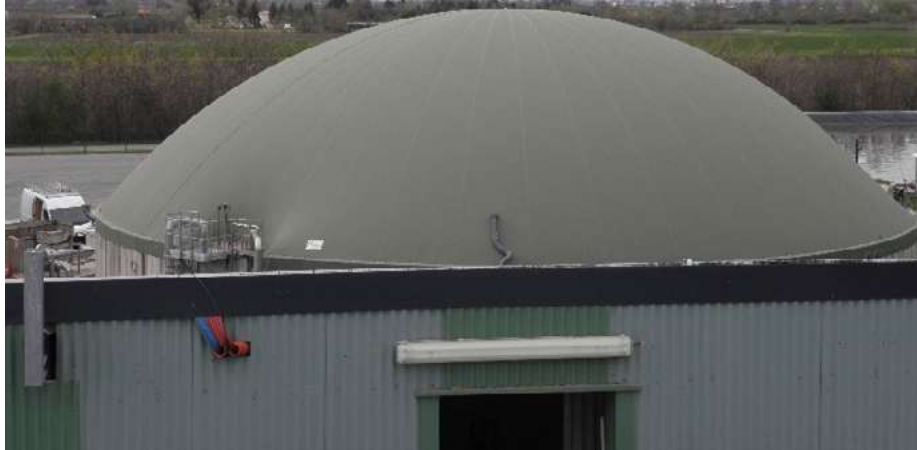
Figure 10 : Vue de la double membrane post digesteur
