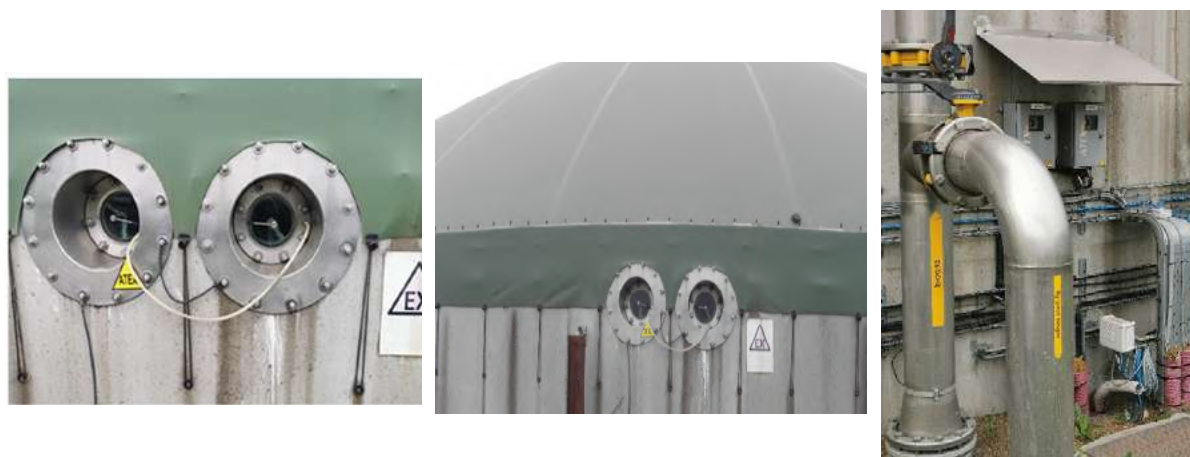
Figure 8 : Vues d'équipement typique d'une installation de méthanisation
