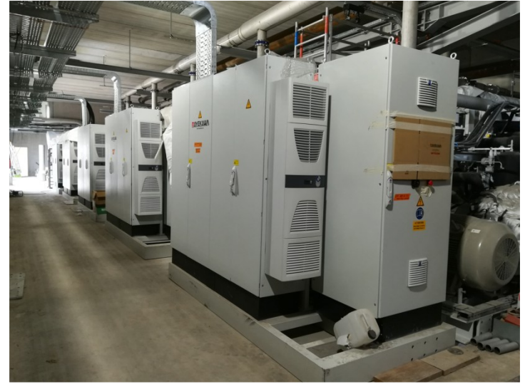
PAC double étage fluide NH3 - Réseau Urbain
