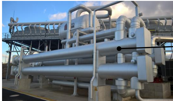
Echangeurs de chaleur (preheaters and evaporator)
