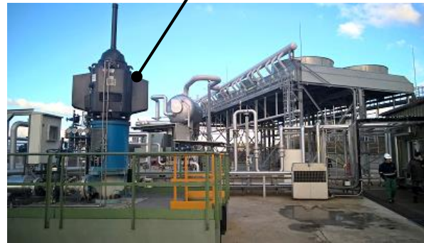
Puits de production (GPK2) avec une pompe à arbre long
