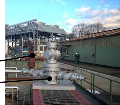
Puits d'injection (GPK3 et GPK4)
