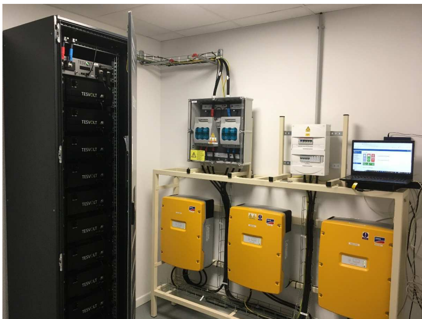
Système de stockage de l'énergie électrique de 13 kW et 48 kWh Installé par EL Smartgrid dans la Région Parisienne
