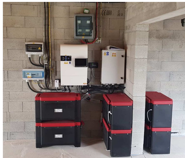
Système de stockage de l'énergie électrique de 15 kW et 81 kWh Installé par EL Smartgrid en Creuse
