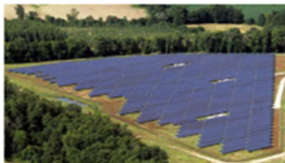
Parc au sol - Grande puissance
