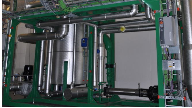
Figure 3 : Détail de la PAC installée à la laiterie Richemonts de Vire (14)
