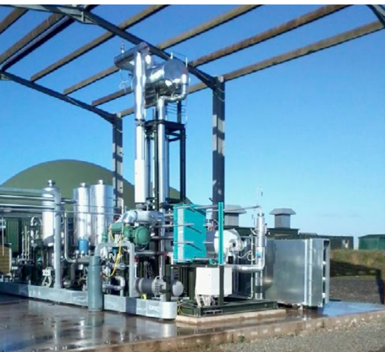
► FIG. 10: UNITÉ DE RÉCUPÉRATION DU CO 2 DE TPI
