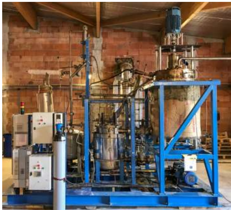
Vue d'ensemble du prototype TURBOSOL, monté sur skid, dans les ateliers à Malataverne (26), la capacité de séparation et la turbine sont à droite.
