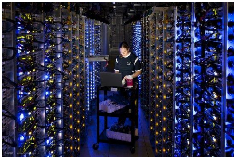
fig 3. Une allée du Data Center de Google
