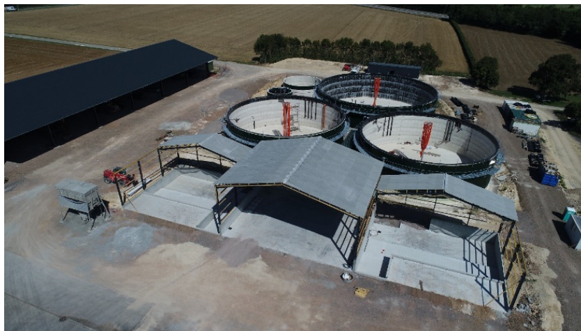
Figure 1 : L'installations de la SAS Beaulieu MÉTHANERGIE, à Argentan en cours de construction au mois de mai/septembre dernier.
