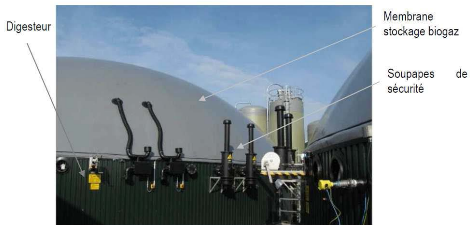
Figure 3 : Photographie d'installation existante (source PlanET)
