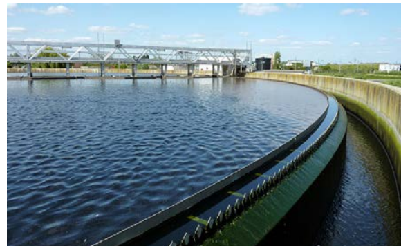
Figure 9: Clarificateur et surverse Source: Communauté d'agglomération
