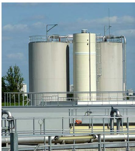
Figure 13: Silos à boues Source: Communauté d'agglomération
