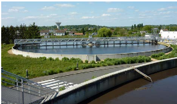
Figure 8: Clarificateur Source: Communauté d'agglomération
