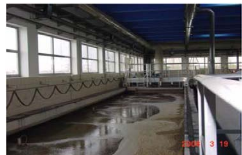
Figure 4: Dessableur et déshuilleur Source : Communauté d'agglomération
