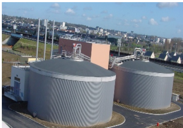
Figure 12: Digesteurs Source: Communauté d'agglomération
