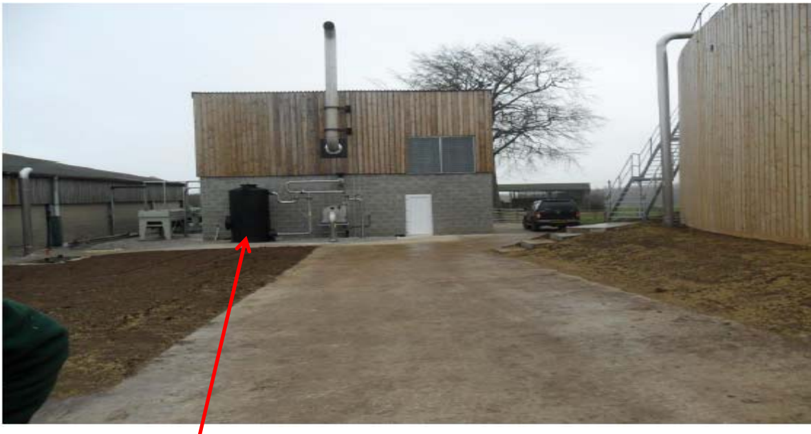
La photo ci-dessus montre le filtre de charbon intact avant son inflammation
