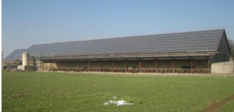
Figure 1 : Bâtiment d'élevage et panneaux photovoltaïques. Source : M.Quaak
