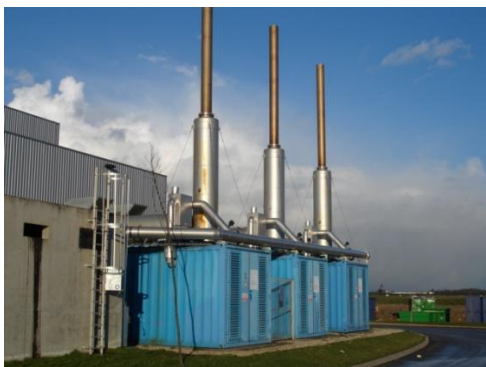
Figure 3 : groupes électrogènes - source SIVOM
