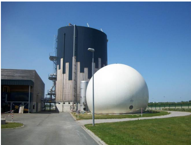
Figure 7: Digesteur et gazomètre - Source: OCTEVA
