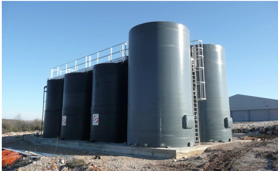
Figure 1: Vue de l'installation de traitement des effluents - Source : Valbio
