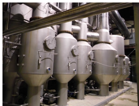
L'évaporateur initial consommant 3 tonnes de vapeur à l'heure
