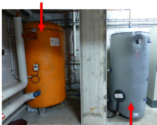
ballon d'eau chaude électrique
