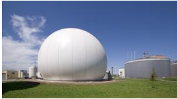
Figure 14: Gazomètre double membrane Source: Communauté d'agglomération
