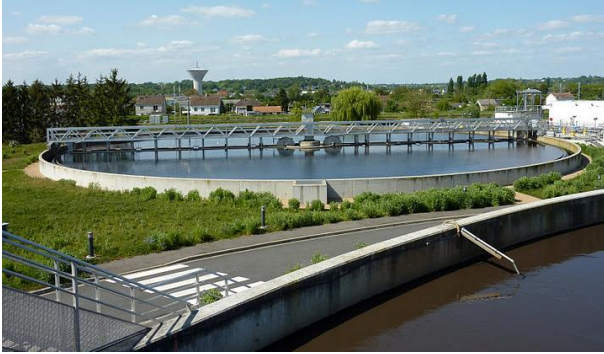
Figure 8: Clarificateur Source: Communauté d'agglomération
