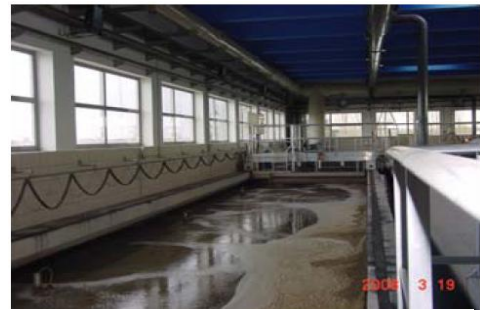
Figure 4: Dessableur et déshuileur Source : Communauté d'agglomération
