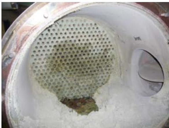
Figure 4: Echangeur endommagé par des résidus de siloxanes
