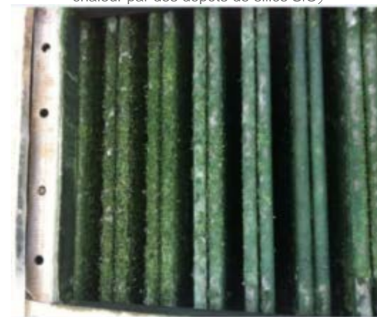
Figure 6 : Dépôt de sulfate ferrique hydraté (Fe 2 (SO 4 ) 3 · x H 2 O) sur l'échangeur fumée
