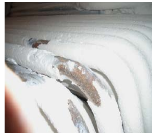
Figure 3 : Colmatage d'un échangeur de chaleur par des dépôts de silice SiO 2
